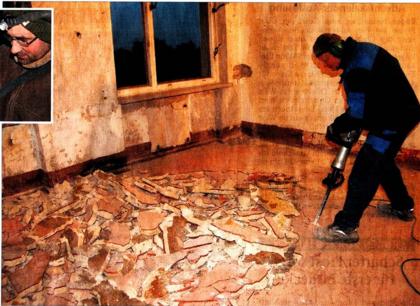
Frank Wondrejz lässt den Presslufthammer rattern. Alle Fußböden im Block V in Prora werden rausgerissen. Fotos (2): U. B.
