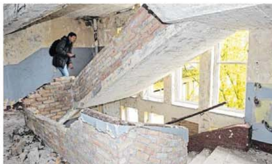
Brösel-Beton überall: Obwohl die Hülle des Blockes von außen noch recht intakt aussieht, gibt es im Innern längst auch statische Probleme.
